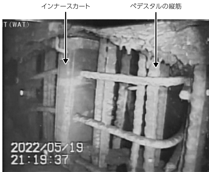
写真1 事故後のペダスタル開口部付近 (出典：東京電力ホールディングス)
